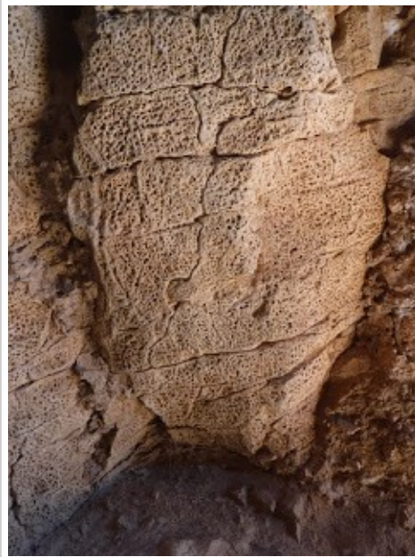
Pared afectada por corrosiones.
