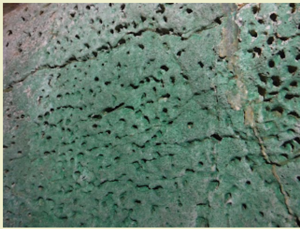
Agujeros de corrosión por condensación próximos a la entrada.
