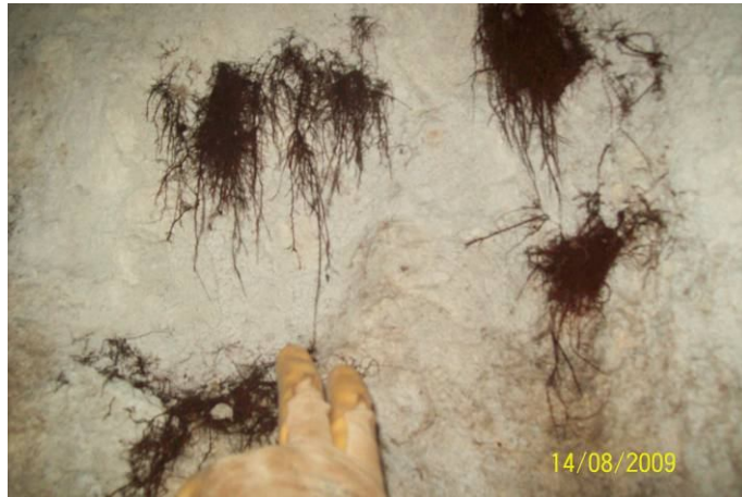
RAÍCES EN LA PARTE SUPERIOR DE LA FRACTURA
