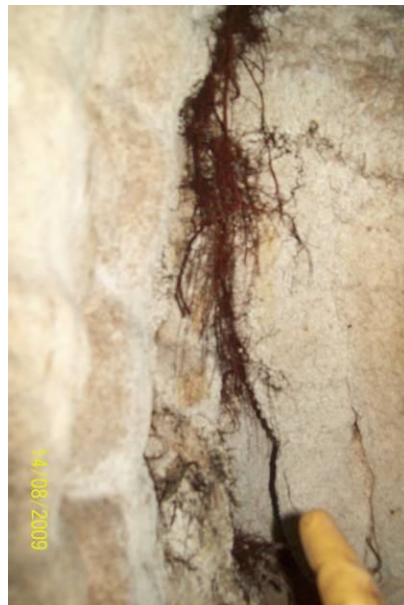
RAÍCES EN LA PARTE SUPERIOR DE LA FRACTURA
