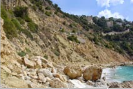
Acantilado inestable (Javea)
