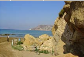
Desprendimientos en la playa
