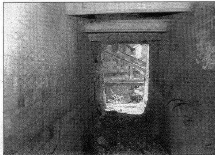
La galería principal que alimenta al Molí, se encuentra totalmente seca. El nivel del agua alcanzaba siempre un centímetro de 30 cm.
