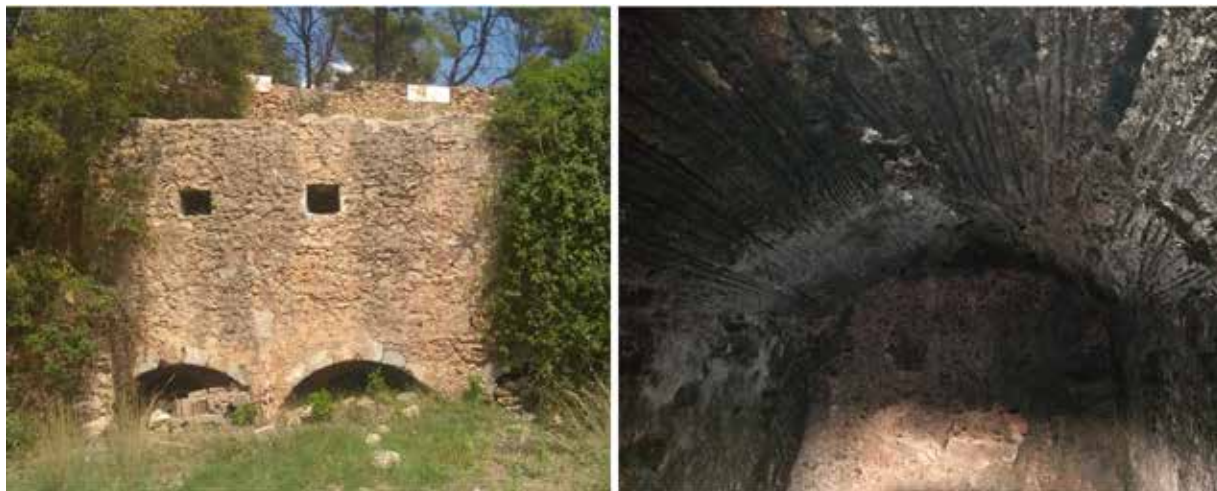
FIGURA 4. Caseta dels Moros, con tres arcos de piedra en la parte inferior y paredes de argamasa. A la derecha, detalle del interior con los techos a modo de bóveda de aljibe (año 2018).
