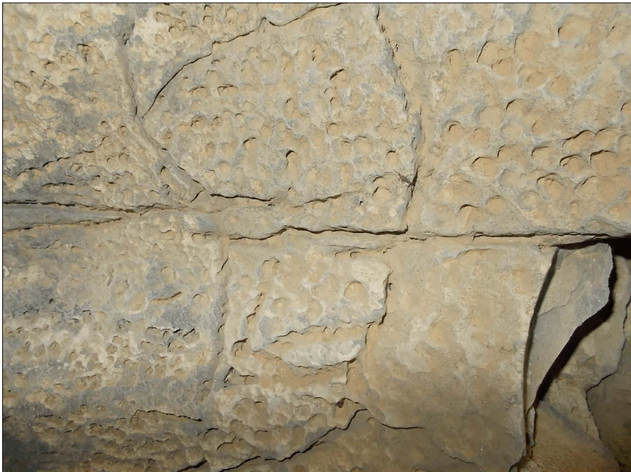
Figura 7. Forats i línies de corrosió. L'ample de la foto és de 30 centímetres
