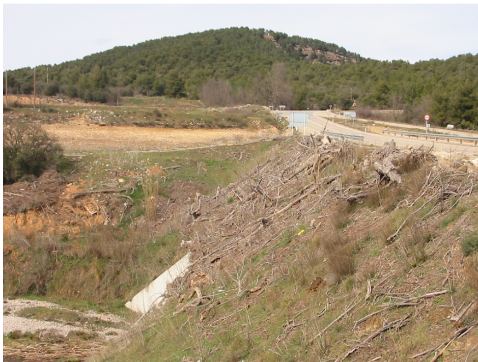
FOTOGRAFIA 2. PARADA 2 La brossa acumulada darrera del pont nou
