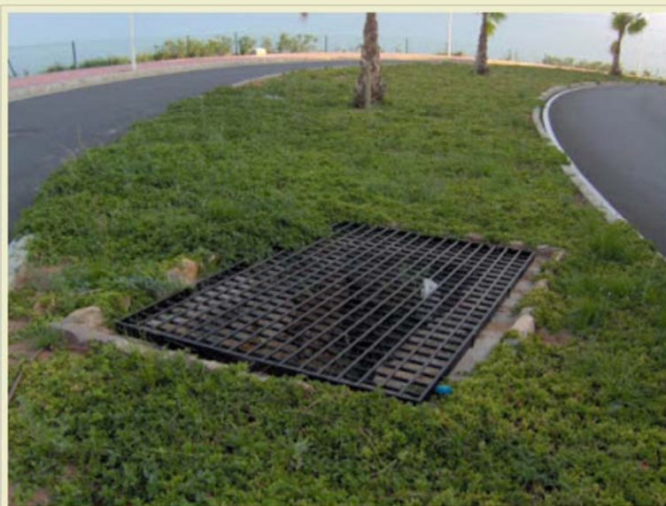
Avenc estret tapat i al mig d'un carrer de la urbanització.
