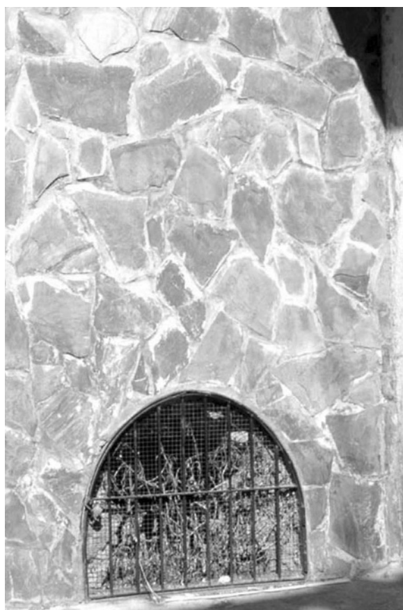
Fotografía 6: El refugio de la Fuente del Lirio, al inicio de la calle Larga, se encuentra en la actualidad totalmente inundado, lo que impide el acceso a su interior.
